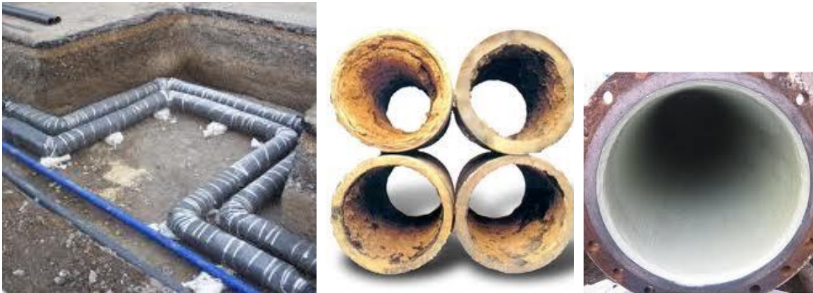
Abb. 3 Kurze Bögen, Ablagerungen und Betonbeschichtung
